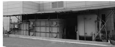
排水処理設備 (10/6撮影)
