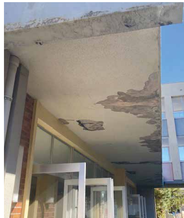
一部が剥がれ落ちた屋根の軒下(現在は補修済み)
