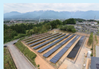
リユース品を使用した発電所
