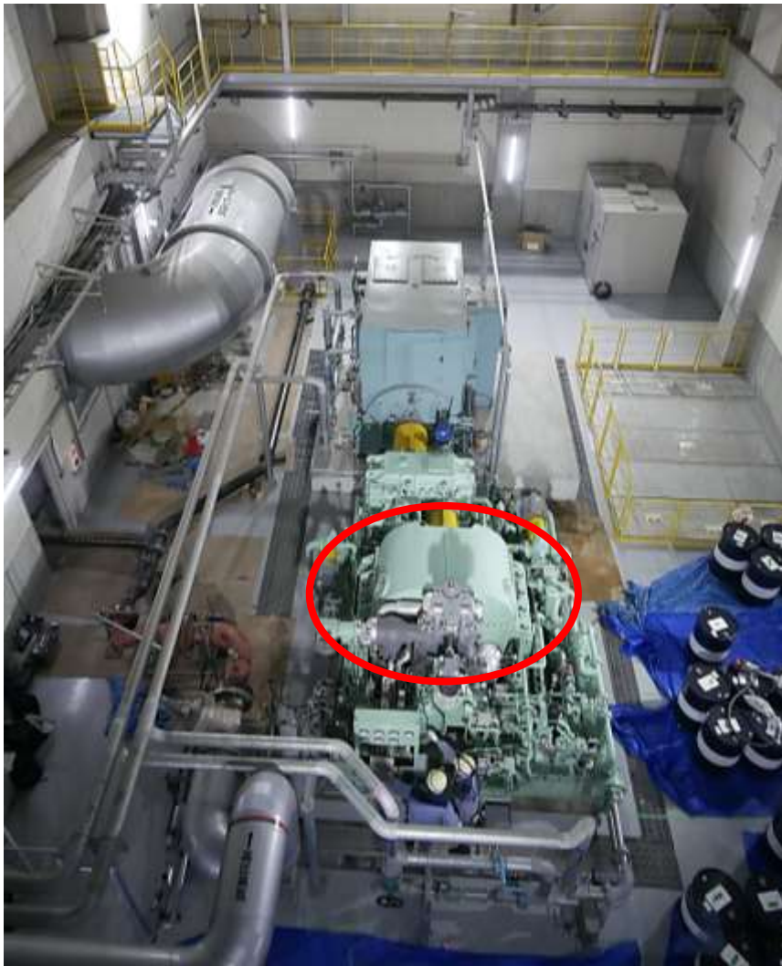
蒸気タービン発電機室 写真
