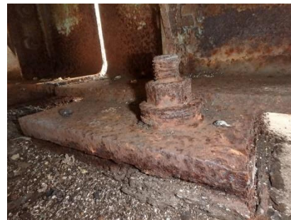
支承に腐食が見られます（区分Ⅱ）
