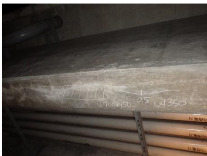
主桁にひびわれが見られます（区分Ⅱ）
