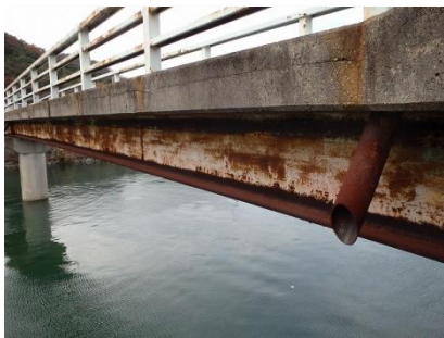
主桁に腐食が見られます（区分Ⅱ）
