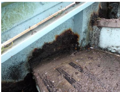
主桁に腐食が見られます (区分Ⅲ)
