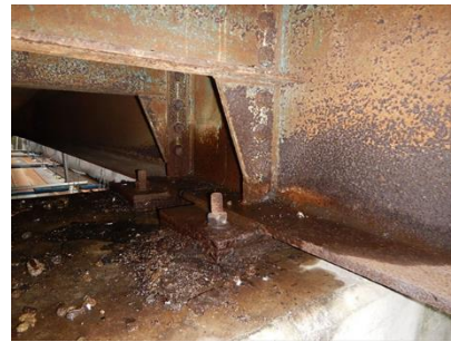
支承に腐食が見られます (区分Ⅲ)
