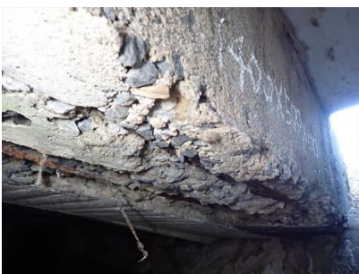
主桁に剥離・鉄筋露出が見られます (区分Ⅲ)
