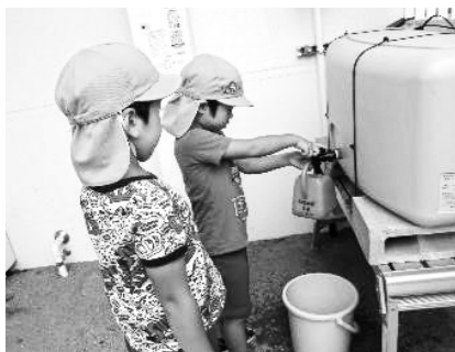
雨水貯留タンク
