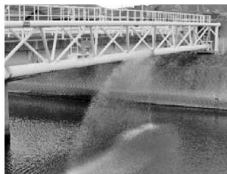
老朽化した管路の漏水 (第2天川橋水管橋)
