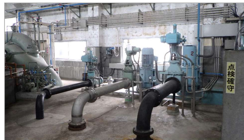
高砂浄化センター合流ポンプ室(内部)
