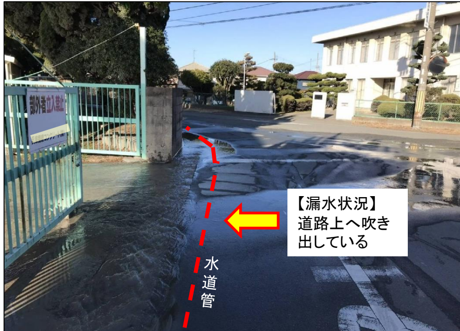
【令和元年度 伊保崎南付近 漏水現場】 CIP(鑄鉄管) Φ200mm S36年布設
