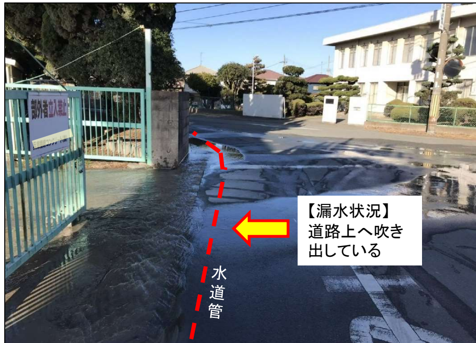
【令和元年度 伊保崎南付近 漏水現場】 CIP(鑄鉄管) Φ200mm S36年布設
