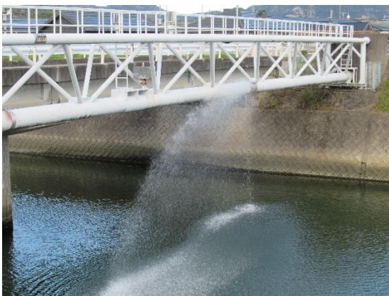
【令和3年 第2天川橋水管橋 漏水現場】 SP(鋼管)φ500mm S55年布設
