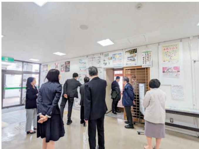
阿弥陀地域交流センターにおける雨漏り対策の確認
